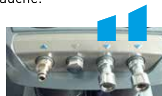
Wasserausgabe der Anschlüsse beim Anschluss von 2 Stangen.
